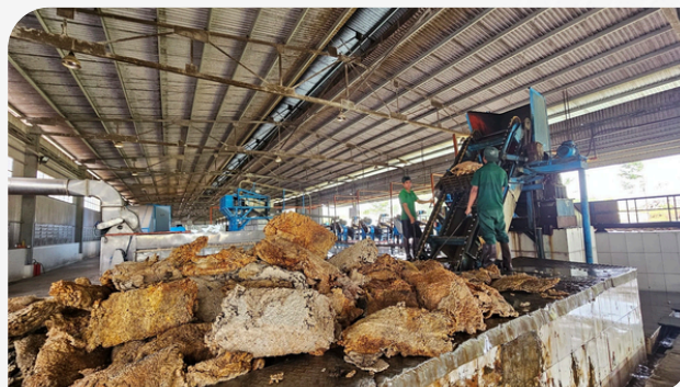
Cung cấp lắp đặt chuyên giao công nghệ máy ép bùn cho HTXLNT cao su
